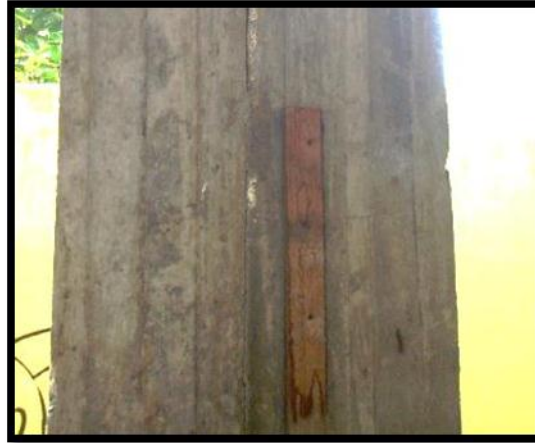
Figura 33. Evidencia de restos de encofrado aun adosados a la estructura.
