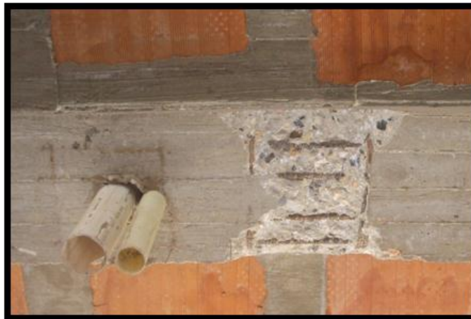
Figura 34. Viga atravesada por instalaciones de aguas blancas.
