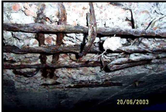
Figura 14. Corrosión del acero de refuerzo de una losa. Nota: Tomado de Construcción IV – Instituto de la Construcción Facultad de Arquitectura - UDELAR. (Sin año).
