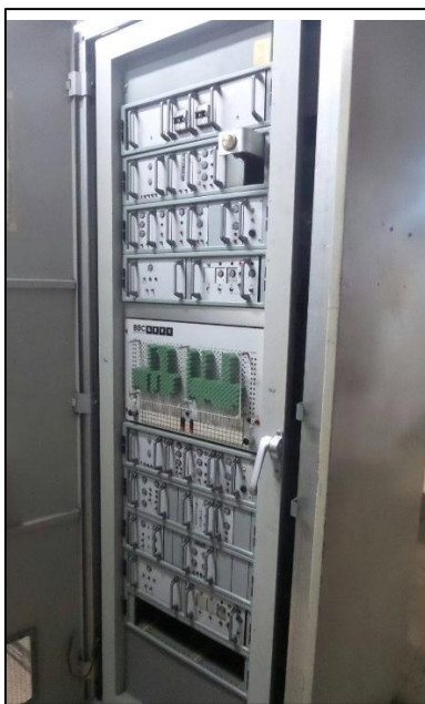
Figura 3.7 Unidad de protección GSX5 BBC en Armario HH01. Fuente: Elaboración Propia.
