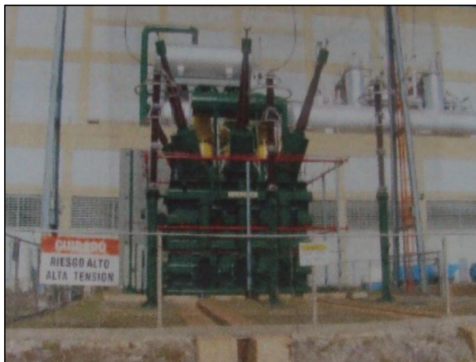
Figura 3.3 Transformador Principal, 3AT01. Fuente: Elaboración Propia.
