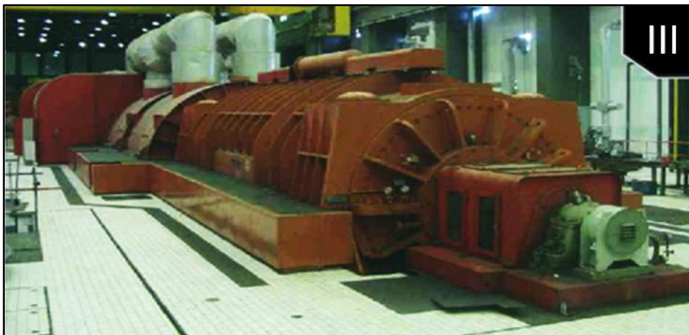
Figura 3.2 Generador Principal 3G, Unidad III. Fuente: Presentación de Ciclo Térmico Planta Centro.
