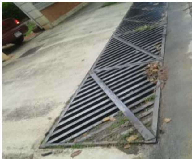
FOTO N° 5.- Vista de sumidero de ventana en la Av. Cabriales, Urbanización La Trigaleña.
