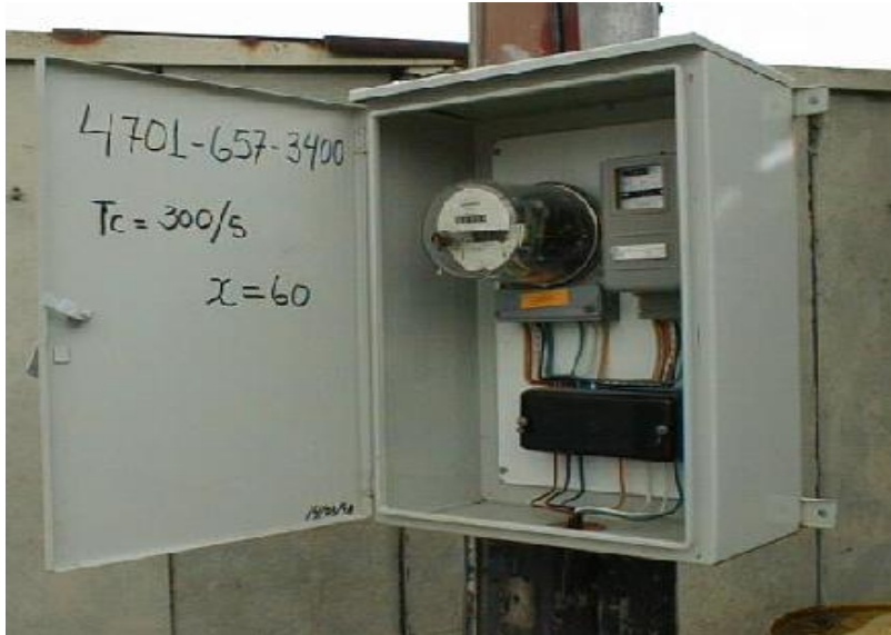
Figura 2.39 Caja del Medidor
