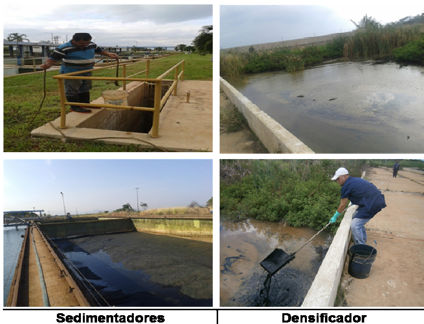
Figura 3.2 Captación de los lodos generados en la planta potabilizadora Dr. Alejo Zuloaga.
