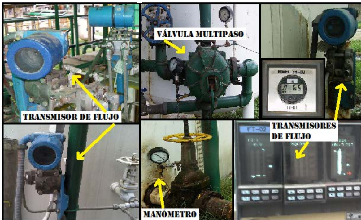
Figura 4.6. Instrumentación obsoleta de la instalación I-103.
