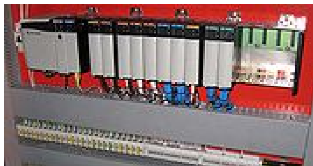
Fig.2.3 PLC moderno instalado (2008) dentro del tablero eléctrico.
