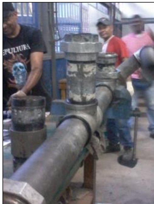
Figura 14. Uniones universales, nipples y tees del manifold en acero galvanizado del sistema de turbina Francis y turbina Pelton del Laboratorio de Hidráulica, Universidad de Carabobo.
