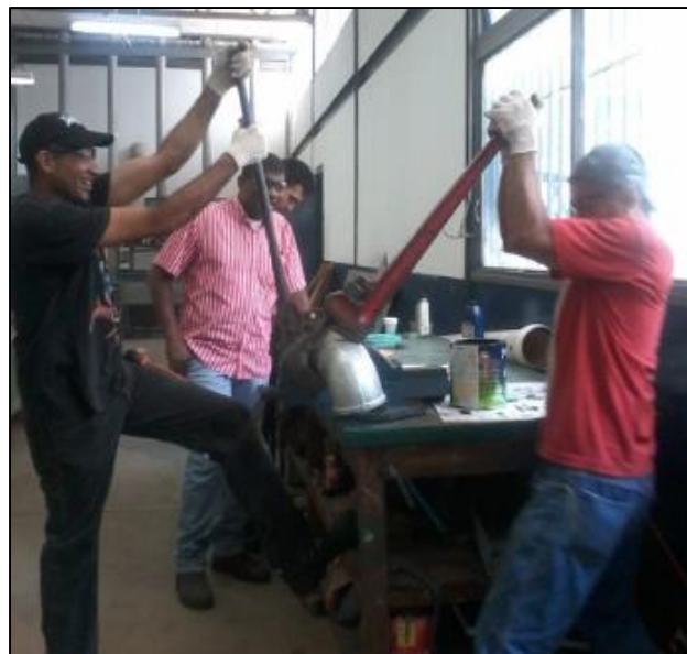
Figura 12. Ensamble del codo de la turbina Pelton en el manifold de acero galvanizado del sistema de turbina Francis y turbina Pelton del Laboratorio de Hidráulica, Universidad de Carabobo.
