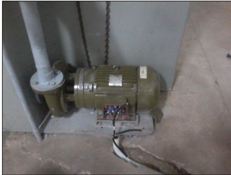
Figura 15. Bomba centrífuga del subsistema de distribución instalada en su ubicación final, con soportes inferiores, conexión bridada e instalación eléctrica. Sistema de turbina Francis y turbina Pelton del Laboratorio de Hidráulica, Universidad de Carabobo.
