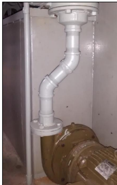
Figura 16. Tubería de descarga de la bomba centrífuga de distribución de caudal del sistema de turbina Francis y turbina Pelton del Laboratorio de Hidráulica, Universidad de Carabobo.
