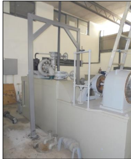
Figura 17. Estructura de soporte del manifold en acero galvanizado instalado y fijado a los cimientos del Laboratorio de Hidráulica, Universidad de Carabobo.
