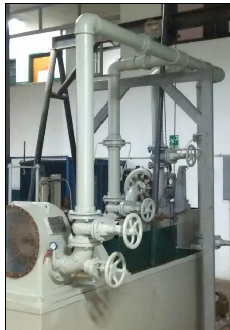
Figura 18. Manifold de distribución en acero galvanizado instalado en el sistema de turbina Francis y Turbina Pelton del Laboratorio de Hidráulica, Universidad de Carabobo.
