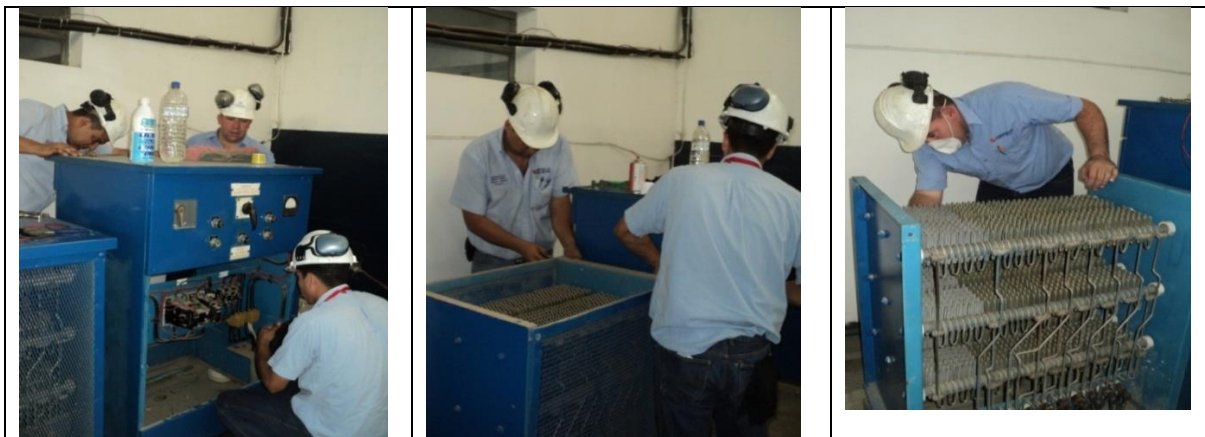
Figura 1. Mantenimiento del Panel de control del Banco de Generador eléctrico de baja potencia (Turbina Kaplan) por personal de CORPOELEC-Planta Centro en el Laboratorio de Hidráulica “Elías Sánchez Díaz”, Universidad de Carabobo.
