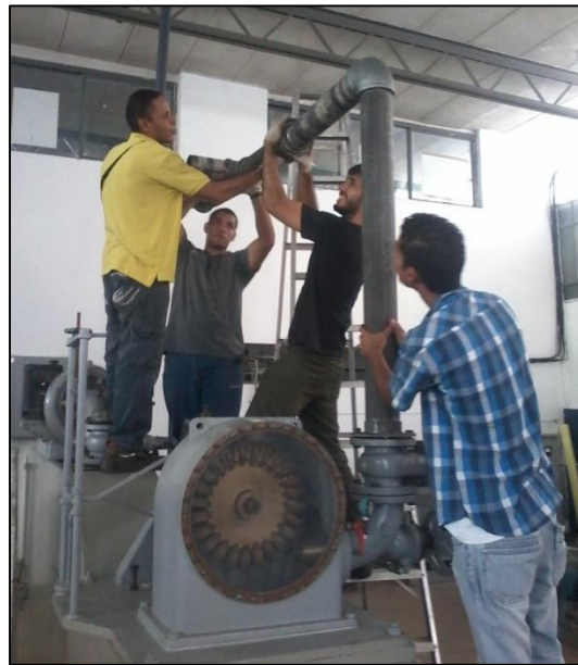
Figura 11. Ensamble preliminar del manifold en acero galvanizado del sistema de turbina Francis y turbina Pelton del Laboratorio de Hidráulica, Universidad de Carabobo.
