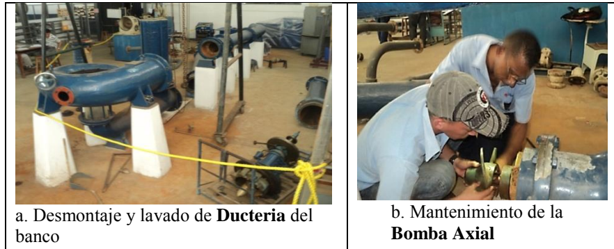
Figura 4. Mantenimiento de los ductos y bomba axial del sistema de recirculación de agua por personal de CORPOELEC-Planta Centro en el Laboratorio de Hidráulica “Elías Sánchez Díaz”, Universidad de Carabobo.
