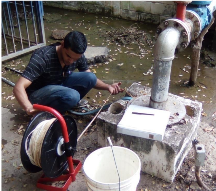
Figura 22. Lectura del nivel dinámico del pozo Fin de Siglo Coordenadas UTM 613362E; 1130425N. Elevación: 465 msnm. Zona centro, Municipio San Diego, Estado Carabobo. Fecha: 11/08/2017.
