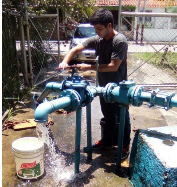
Figura 28. Medición del caudal variable del pozo Montserino (Coordenadas UTM 613448E; 1134925N. Elevación: 468 msnm. Zona centro, Municipio San Diego, Edo. Carabobo. Fecha: 08/09/17.
