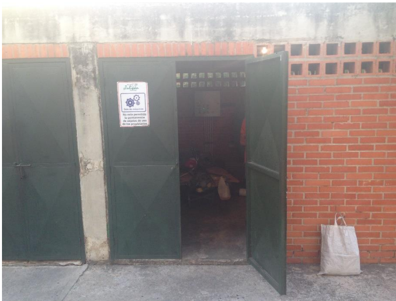
Figura 13. Caseta de Cobertura para el Tanque que recibe el Suministro de Agua de los Pozos N° 1 y 6. Fuente: Los Autores (2019)
