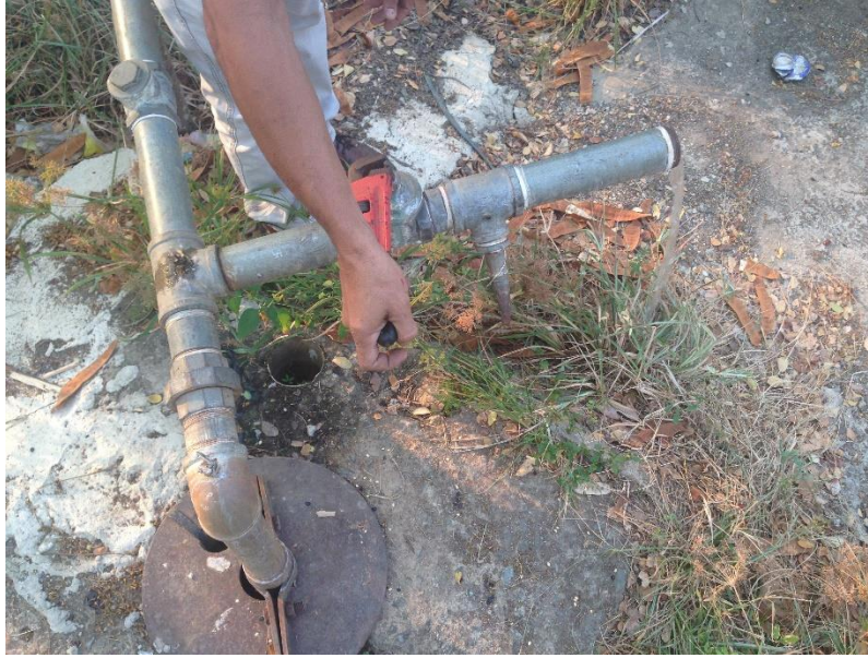
Figura 12. Prueba de Caudal Variable. Fuente: Los Autores (2019)
