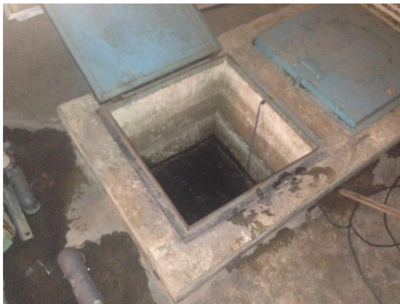
Figura 14. Boca de Visita del Tanque que recibe el Suministro de Agua de los Pozos N° 1 y 6. Fuente: Los Autores (2019)
